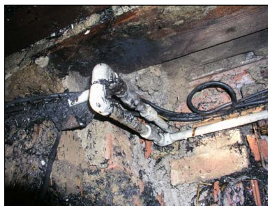
Obr. 1: Ohřev tohoto plastového vodovodního potrubí PB hořákem měl za následek požár rodinného domu.
